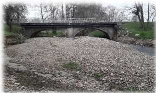
Figure 20 : Atterrissement à Montmaurin avant traitement
